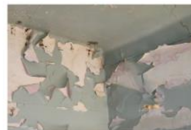
Peinture écaillée contenant du plomb
