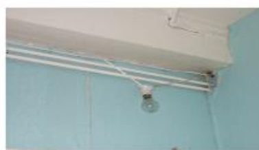
Eclairage insuffisant et dangereux
