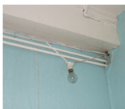
Éclairage insuffisant et dangereux
